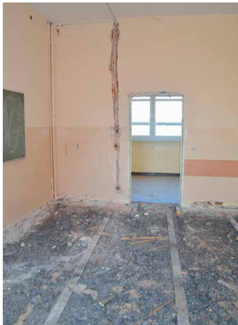
Zniszczony parkiet zostanie wymieniony na nowy
